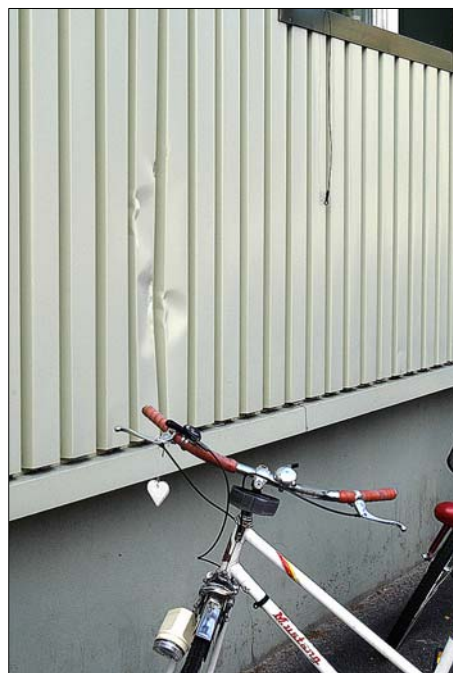
Typisk skada på plåtfasad, hus på Prinsvägen, från sydost. Nbm acc.nr 2004:120:10
