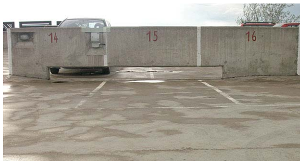
Den låga mur som är ställd över vattenavrinningsrännan och skiljer parkeringsdäckets två halvor åt. Nbm acc.nr 2006:30:09
